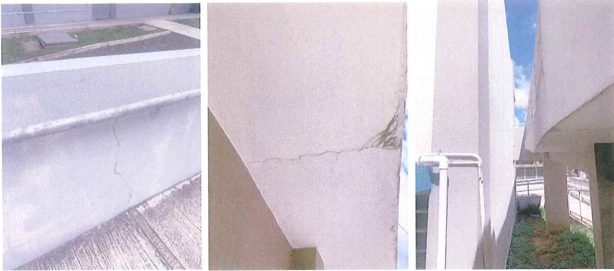
Fotos: Grietas en rampa de impedidos.
