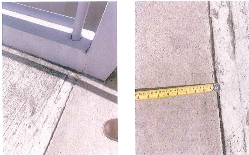
Fotos: Separación junta de rampa y pasillo.
